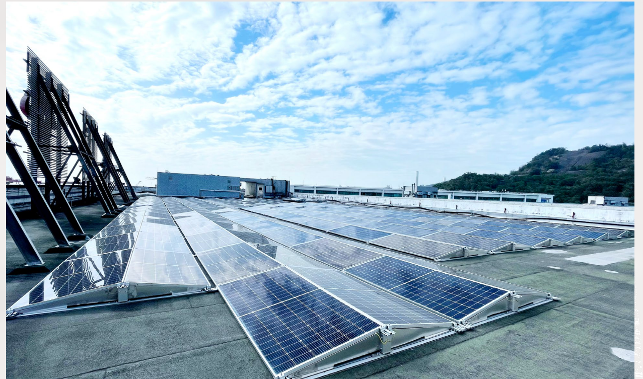
2022 年，珠江船务在香港屯门的珠江货仓引进屋顶太阳能光伏项目
