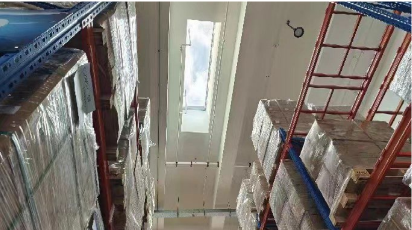
珠江中转新仓库的天花板上安装了中空玻璃。日照时分，光线可以透过玻璃照射到仓库内部，以节省电力
